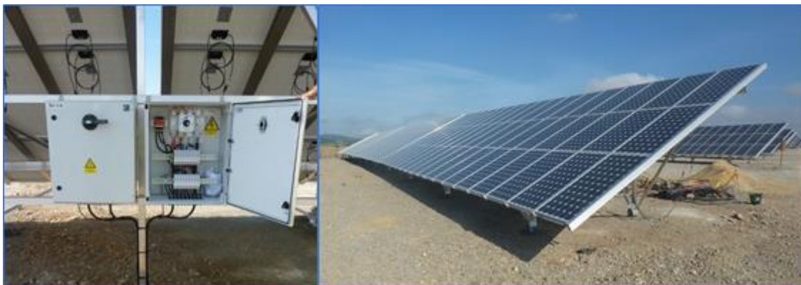
Figure 18: Raccordement des panneaux en série et poste de livraison.
