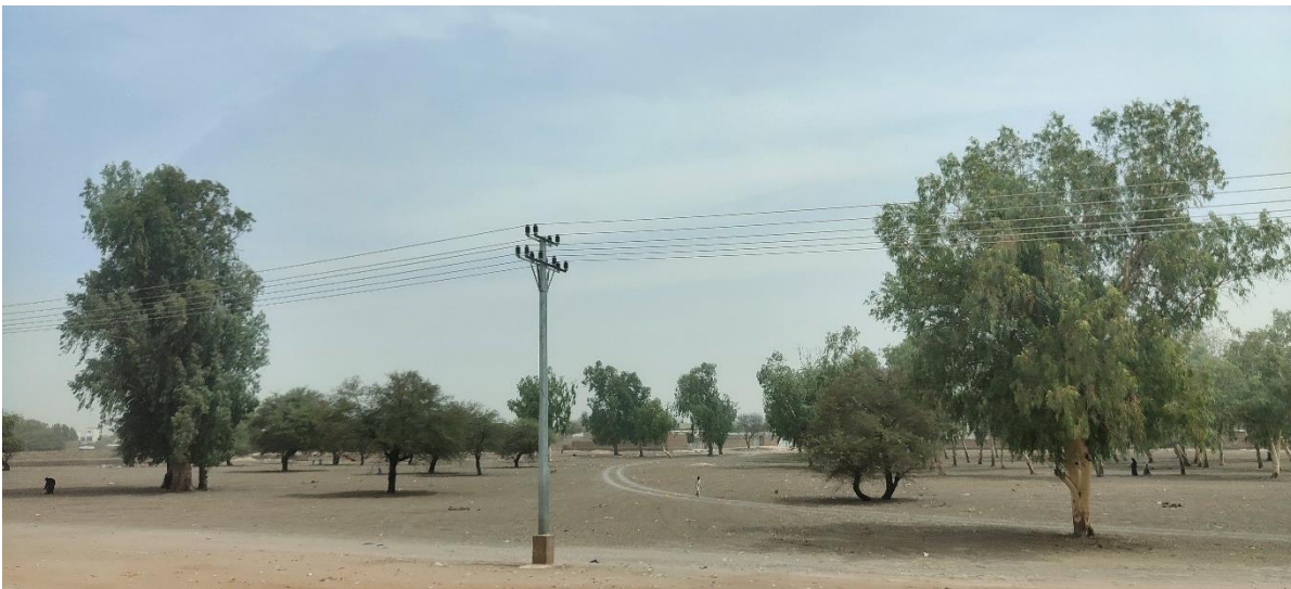
Figure 13 : Exemple de poteau électrique
