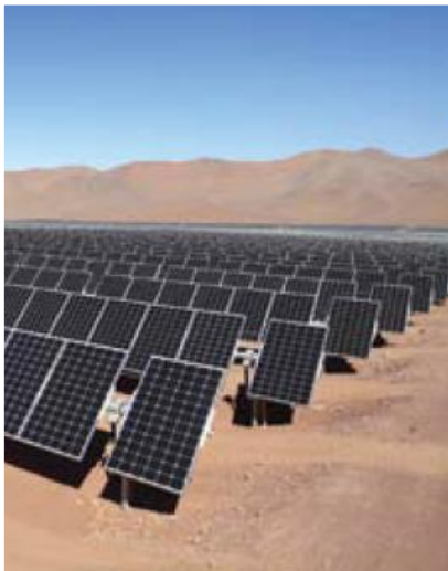
Modules photovoltaïques à trackers
